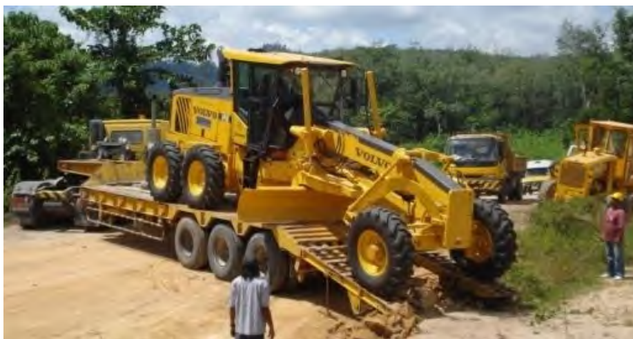
รูปที่ ๕-๒๐ บันไดทางขึ้น-ลงเครื่องจักรกลที่ความแข็งแรงและความลาดเอียงเหมาะสม
