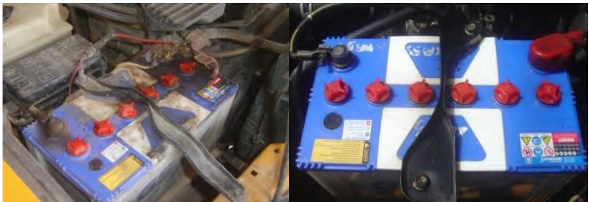
รูปที่ ๔-๖ สภาพแบตเตอรี่ที่ไม่ได้รับการดูแล กับแบตเตอรี่ที่ได้รับการดูแล
