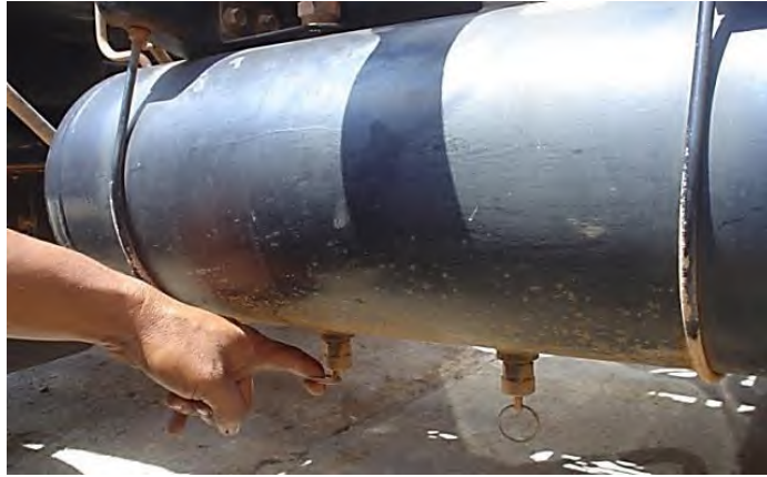
รูปที่ ๔-๑๐ จุดถ่ายน้ำออกจากถังลมเบรก
